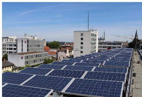
Photovoltaik-Anlage auf Kreisgebäude B am Europaplatz
