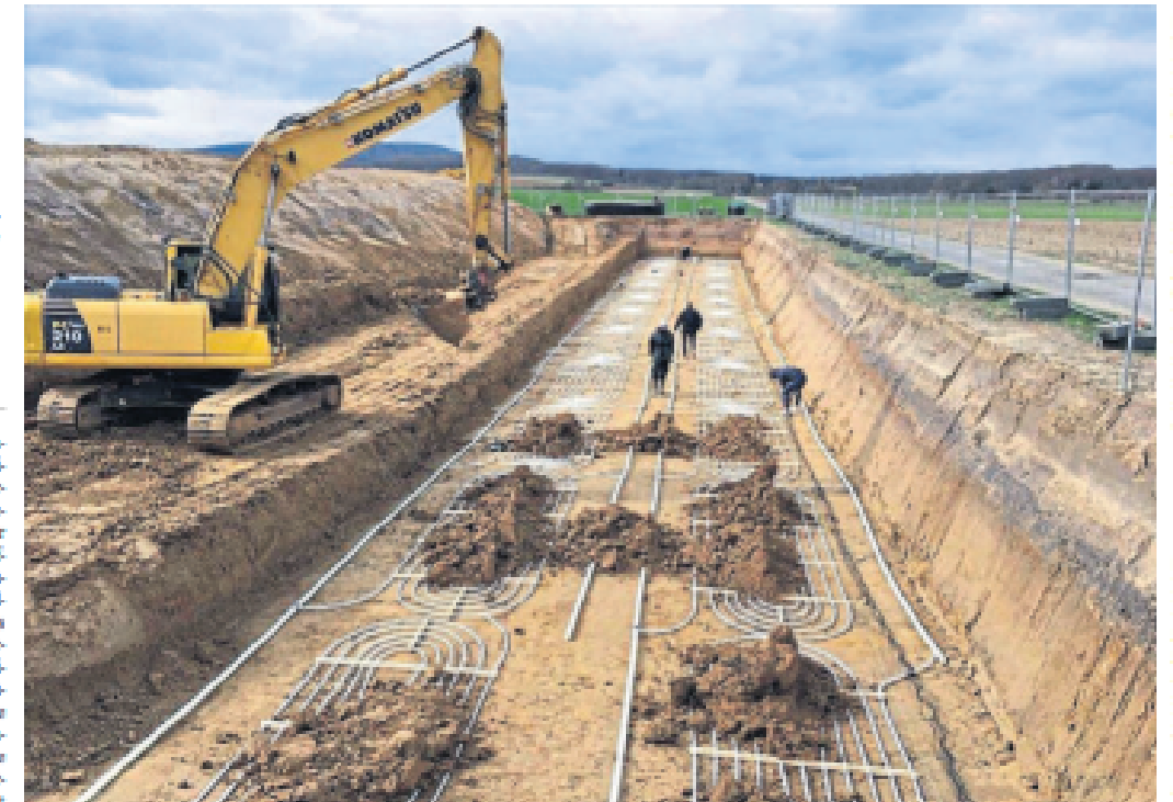
Ein Kälte-Wärmewärme-Netz, wie es zur Versorgung von Bad Nauheim Süd gebaut worden ist, ist womöglich auch eine Option für weitere Eignungsgebiete in der Kernstadt. Schwieriger ist die Lage in den meisten Stadtteilen. ARCHIVFOTO: PUSCHTOWSKI
